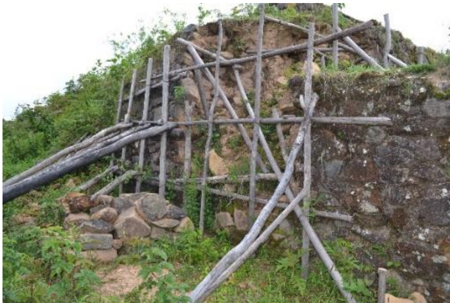
Fig.03. Muros 10a y 9, después del colapso.
