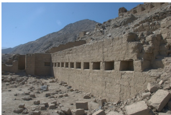
Foto 4. Detalle de técnica constructiva local, de muros con piedras unidas con barro, propia de los Coayllo. Sector 3, vista al noroeste (foto: José Luis Matos, 2012)
