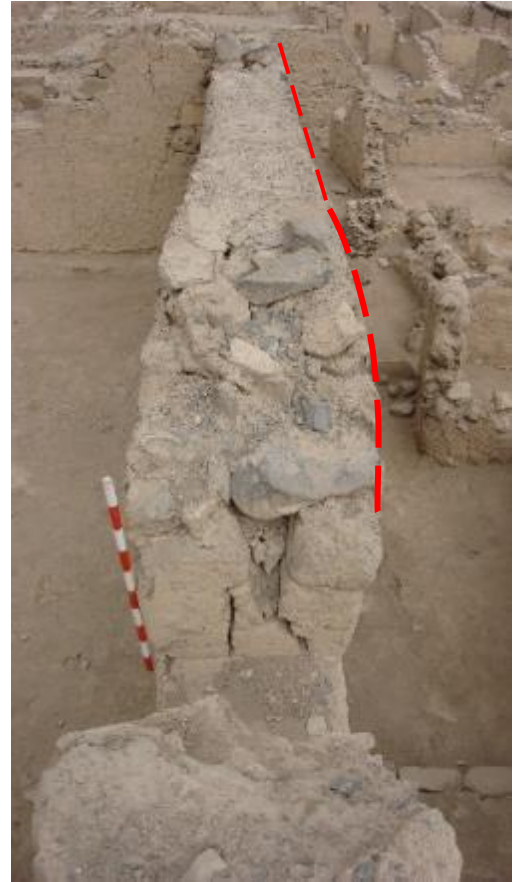
Foto 6: Adobes fracturados y abombamiento de la sección de muro
