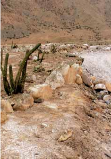
Fig. 23. Segmento VI de Quebrada Culebrilla. En la actualidad solo queda uno de los muros de contención, el cual está cubierto.
