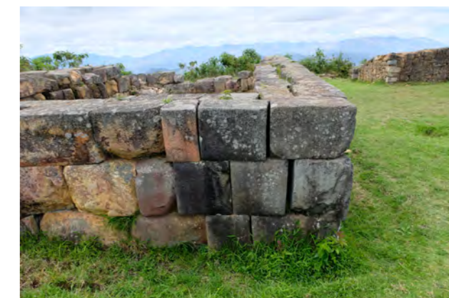
Foto 34. Fractura de elementos por sometimiento al calor. Sitio Aypate. Fotografía: Iván Ccachura
