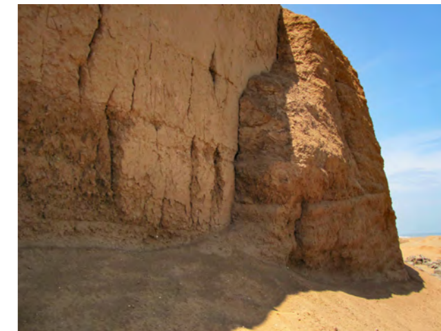
Foto 20. Muros con presencia de erosión en superficie. Sitio El Huarco. Fotografía: Iván Ccachura
