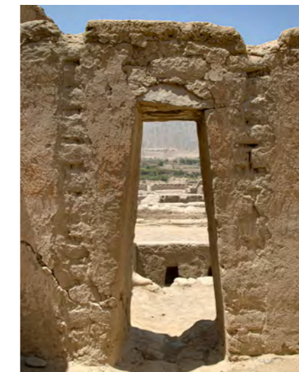
Foto 3. Riesgo de colapso por falla en la unión de los muros. Sitio Tambo Colorado. Fotografía: José Luis Matos
