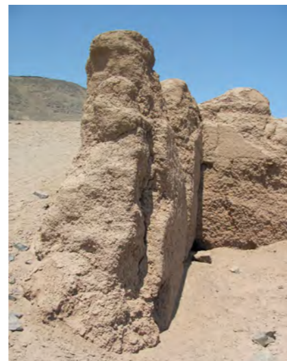
Foto 6. Deformación de un muro de tapial (Bloque de tierra modelada). Sitio El Huarco. Fotografía: Iván Ccachura
