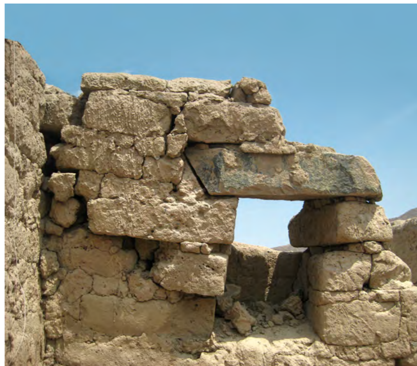
Foto 2. Pérdida de cohesión del mortero de asiento. Sitio Tambo Colorado. Fotografía: Sergio Anchi
