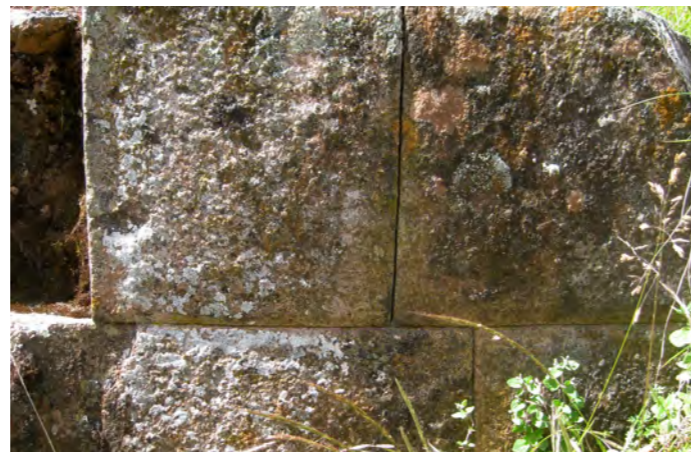
Foto 41. Manchas de origen biológico y medioambiental. Sitio Incahuasi de Huaytará. Fotografía: Sergio Anchi
