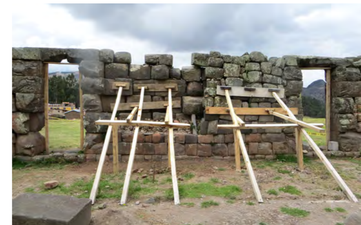
Foto 38. Estructuras en riesgo de colapso. Sitio Vilcashuamán. Fotografía: Iván Ccachura
