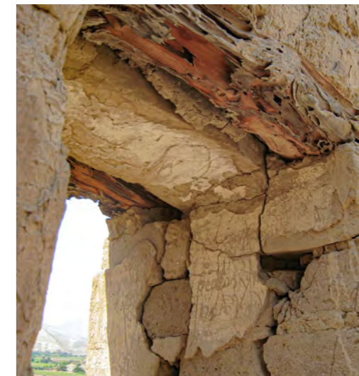
Foto 24. Deterioro de material orgánico. Sitio Tambo Colorado. Fotografía: Sergio Anchi
