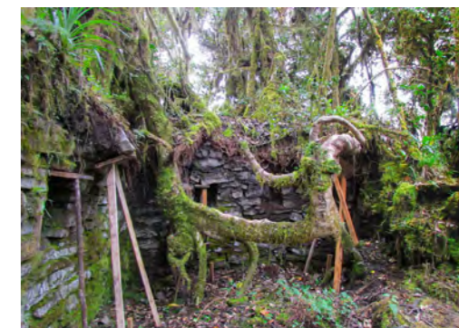
Foto 25. Deterioro de estructura por vegetación invasiva. Sitio Huanacaure. Fotografía: Iván Ccachura
