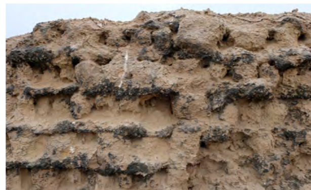
Foto 19. Manchas por eflorescencia de sales. Sitio Cerro del Oro. Fotografía: Iván Ccachura
