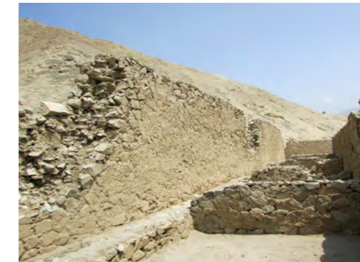
Foto 29. Muros en riesgo de colapso. Sitio Incahuasi de Lunahuana. Fotografía: Iván Ccachura
