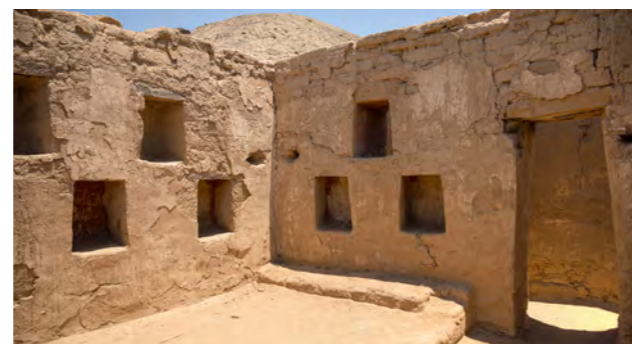
Foto 7. Fracturas en varias secciones de muro. Sitio Tambo Colorado. Fotografía: José Luis Matos
