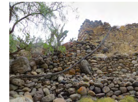
Foto 14. Deterioro de elementos orgánicos (posible baranda) por exposición al medio ambiente. Sitio Puente Inca de Sarhua. Fotografía: Iván Ccachura
