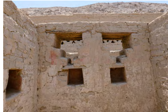
Foto 26. Deterioro de dinteles de madera a causa de insectos. Sitio Tambo Colorado. Fotografía: Iván Ccachura
