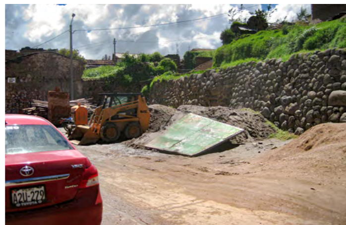
Foto 16. Deterioro por contaminación. Sitio Vilcashuamán. Fotografía: Sergio Anchi
