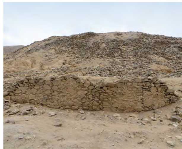
Foto 18. Deterioro del mortero de cohesión en muros del Sitio Incahuasi de Lunahuana. Fotografía: Iván Ccachura
