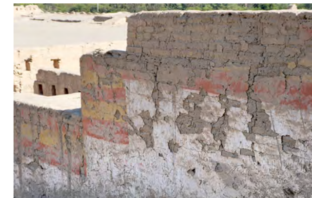
Foto 21. Desprendimiento de la capa pictórica de muros del Sitio Tambo Colorado. Fotografía: Iván Ccachura
